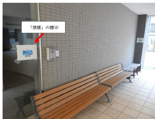
図5 喫煙所反対側のベンチ（喫煙所全体が天井に覆われているため，天井に沿って水平方向にたばこ煙が拡散し効果的に排出されずに停留し，非喫煙者が喫煙所からのたばこの煙のばく露を受けるおそれがある）：報道資料のまま
